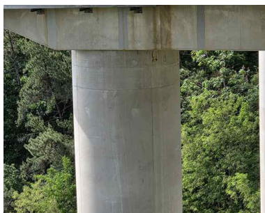
② 교각 망상균열 - 진전 여부확인
