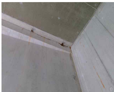
① 거더 파손 - 진전 여부확인
